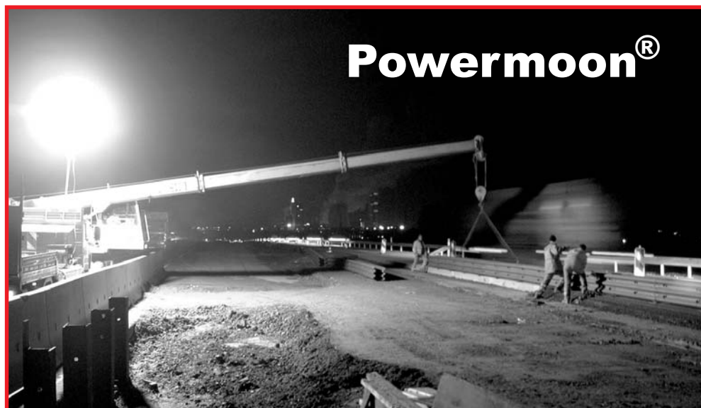
Powermoon® schafft tagesähnliche, blendfreie Lichtverhältnisse, die Einzugsbereiche der Arbeitsumgebung ist ideal ausgeleuchtet
