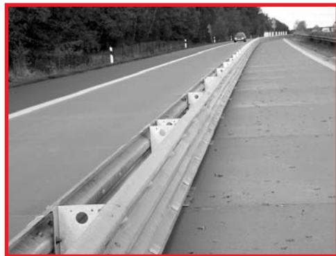
Zwischen entgegengesetzten Verkehrsströmen ist bei einer 2:0-Verkehrsführung eine Schutzwand T3/W4 zwingend vorgeschrieben
