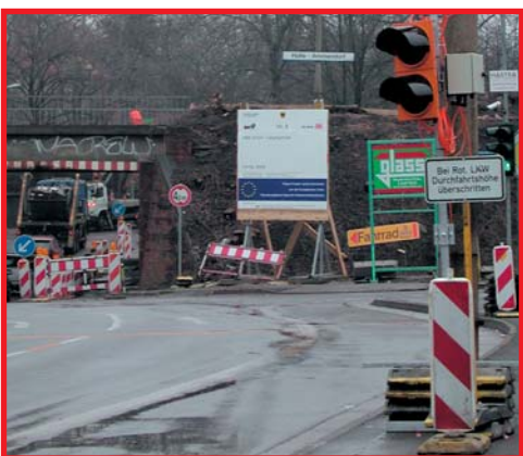
Höhenwarnanlage im Einsatz in Halle/Saale
