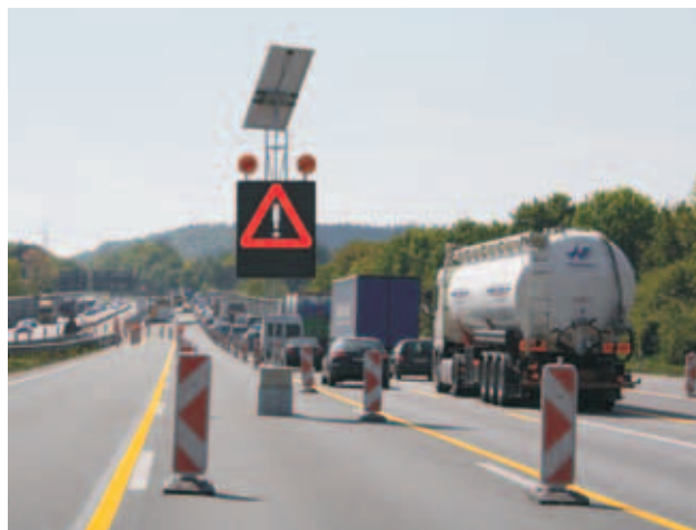
LED-Wechselverkehrszeichen der MIS GmbH an einer Gefahrenstelle im Baustellenbereich auf der BAB 2 Höhe Bielefelder Berg
