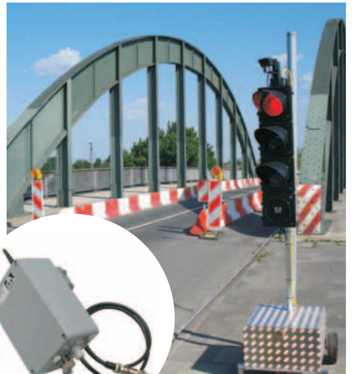
Informationen live von der Baustelle: Das SMS-Überwachungssystem verschickt rechtzeitig vor einem erforderlichen Akkuwechsel und bei eventuell auftretenden Störungen SMS, Fax oder E-Mail an den Service-Monteur
